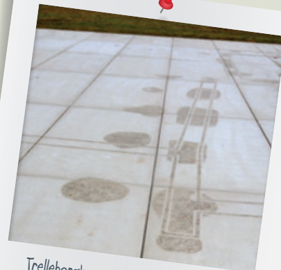
Trelleborghus. Stolpehuller og vægforløb
