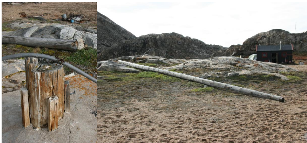
Fig 37. Tv: 'Stub' fra radiomast stående i betonfundament. Den bøjede jernstang er yngre tilføjelse. Th: den væltede radiomast liggende foran klippe med 'stub'.
